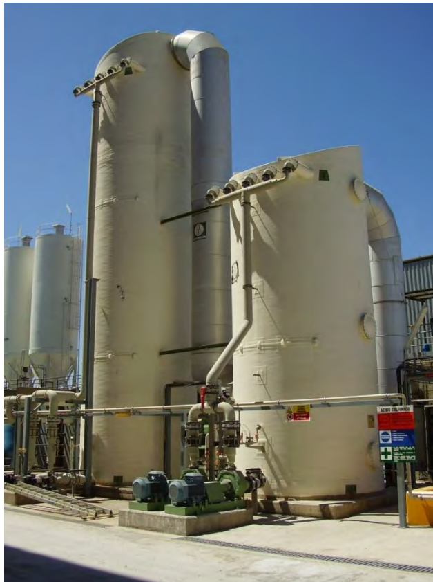
Figura 3.10. Colonna di stripping con annesso scrubber chimico.
