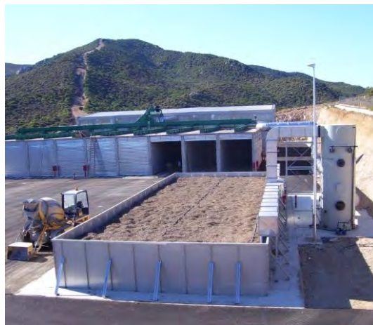
Figura 4.4. Impianto di compostaggio con cumuli statici areati.
