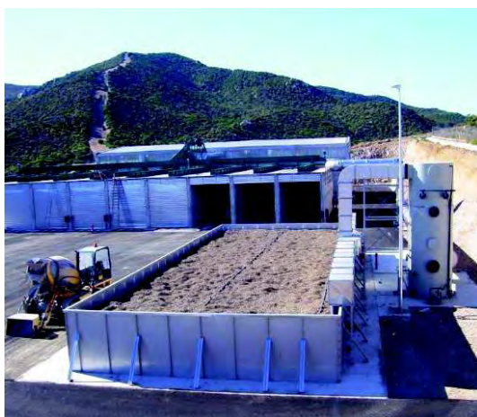
Figura 4.4. Impianto di compostaggio con cumuli statici areati.
